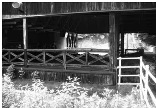
写真5 建屋が荒廃したゴール付近 2019年6月筆者撮影
